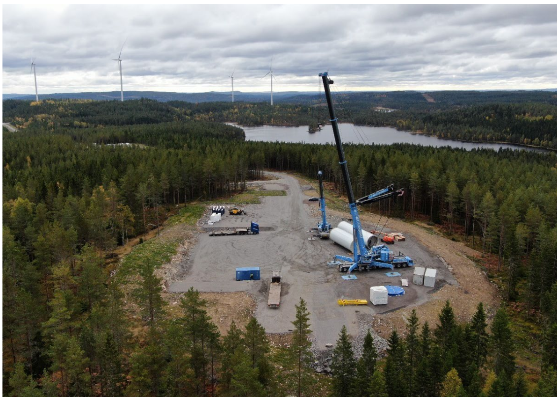
Figur 15. Arbetsytor i vindkraftsparken Norra Länsmansberget i Sunne kommun. Fundament är klart och montering av torn ska påbörjas. För de nedre delarna av tornet används en mindre kran, den som syns på bild. Sedan används en större kran för montering av de resterande torndelarna, maskinhuset, rotorn och rotorbladen. Foto av Jonathan Hjorth.
